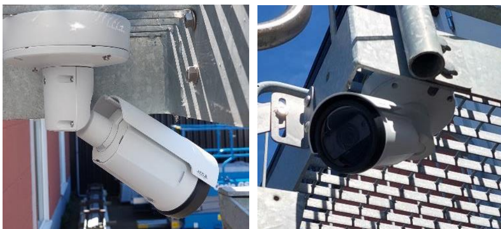
Figur 14 Bild av P1467-LE kameran monterad mot trappans ramverk
